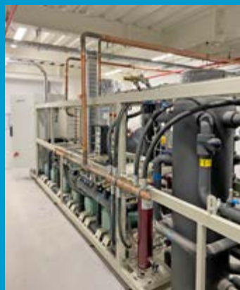
Centrale a CO 2 installata da De Rigo Refrigeration in Uruguay
